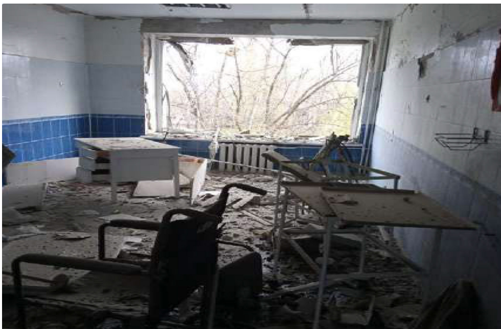
Зруйнована Вугледарська центральна міська лікарня, Донецька область
